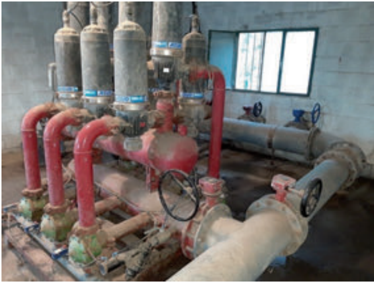
Filtro en mal estado en una instalación de riego por goteo desde balsa
