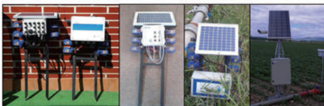
Imagen 12: Programadores GPRS de distintas marcas montados para trabajar con tuberías portátiles de aluminio. Fuente elaboración propia.
