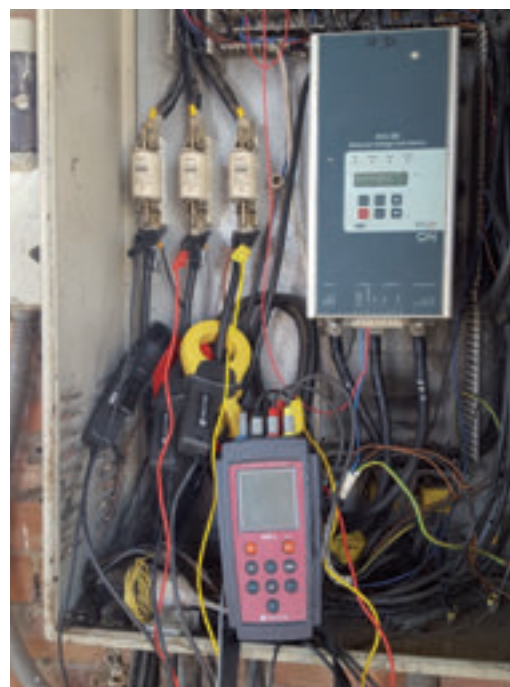
Medida de parámetros eléctricos en cuadro con analizador de redes portátil no invasivo.
