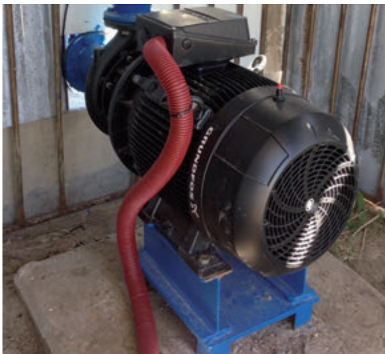
Motor y bomba horizontal para impulsión desde balsa.
