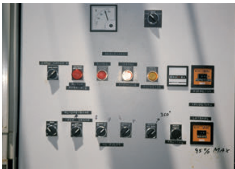
Cuadro de control eléctrico de automatismos.
