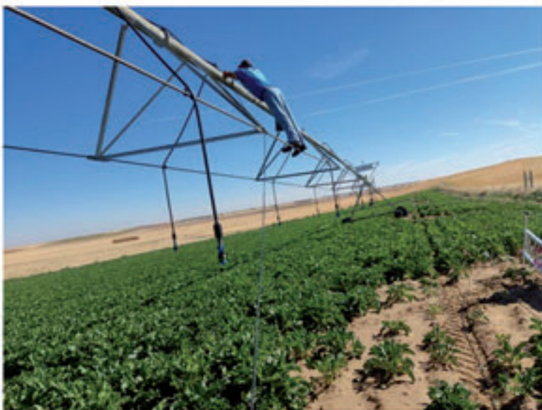
Instalación de Rotator® en los bajantes del pivot del demostrador, por fuera de los tirantes.
