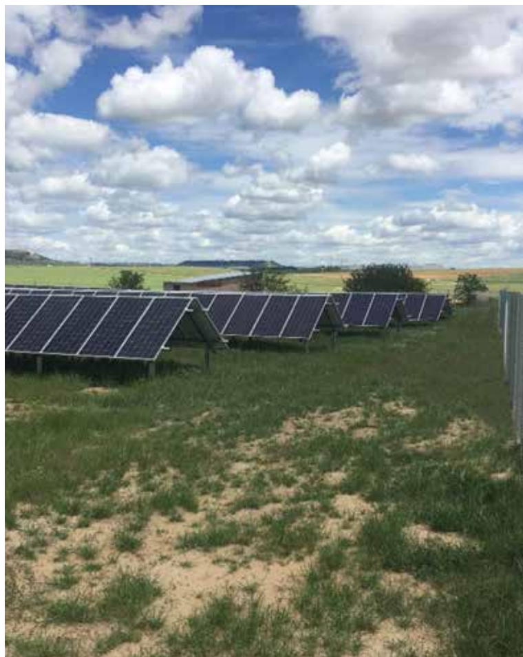
Instalación en Torrecilla de la Abadesa de 106 Kwp para regar 35 ha. de diversos cultivos
