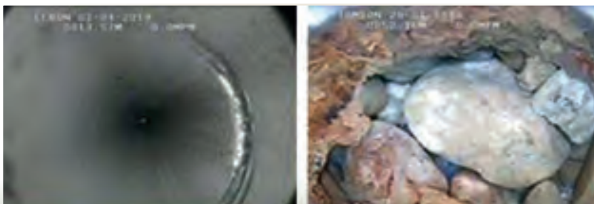
Figura 5. Fotografías tomadas con cámara de televisión axial y lateral mostrando la rotura que presenta la tubería de revestimiento del sondeo por el roce de las bridas de la tubería de impulsión de una bomba vertical.
