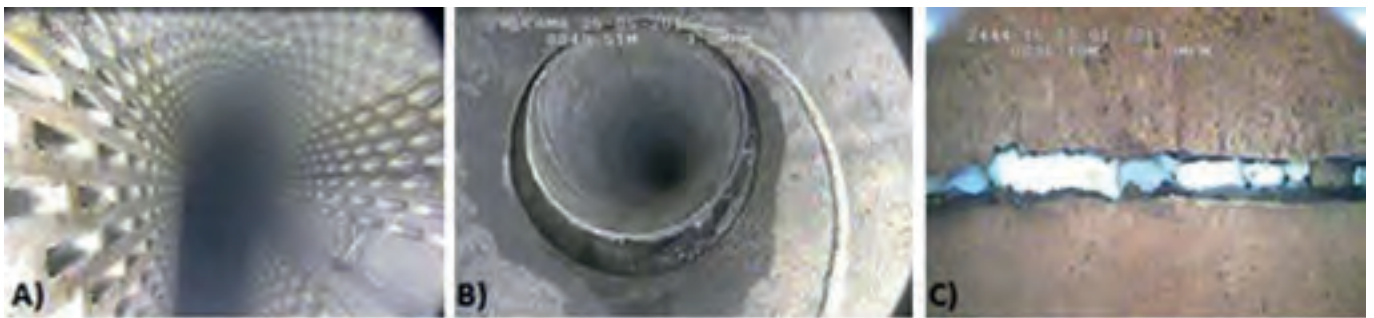
A) Fotografía tomada de un sondeo de reciente construcción que sufrió un aplastamiento durante la realización del aforo, probablemente como consecuencia de una mala ejecución durante el engravillado.
